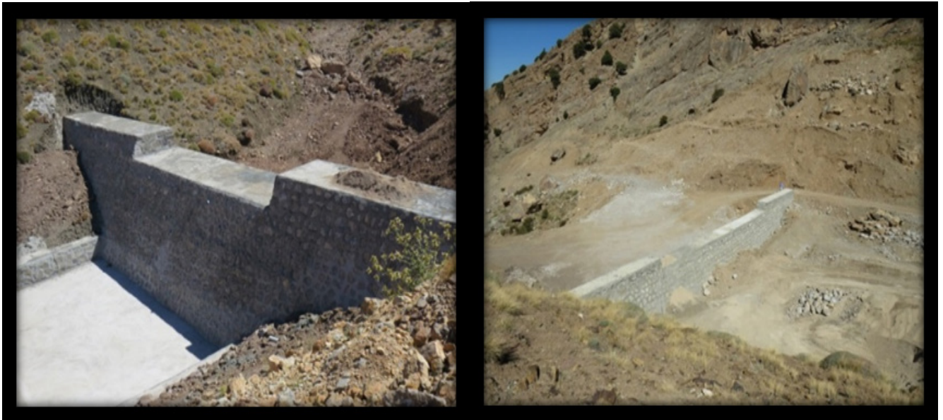
شکل ۹. سازه‌های آبخیزداری احداث شده در معدن بوکسیت تاش (تصویر راست T۱ و تصویر چپ T۲)
